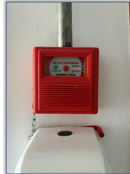
Alarme contra incêndio
